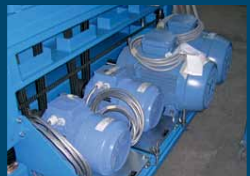
Motoren im Trockenbereich / Motors in dry zone
